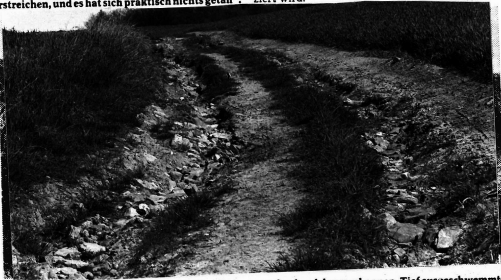
Die Wege durch Steinachs Fluren sind teilweise kaum mehr als solche zu erkennen. Tief ausgeschwemmte Fahrinnen machen sie für die schweren Landmaschinen, die eigentlich auf ihnen rollen sollten, fast nicht mehr passierbar. Und auf eine Wende durch die Flurbereinigung zum Besseren warten die Landwirte nun schon seit Jahren.
